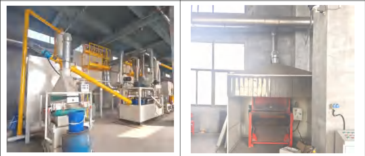
破碎振动金塑分离一体机废气收集
