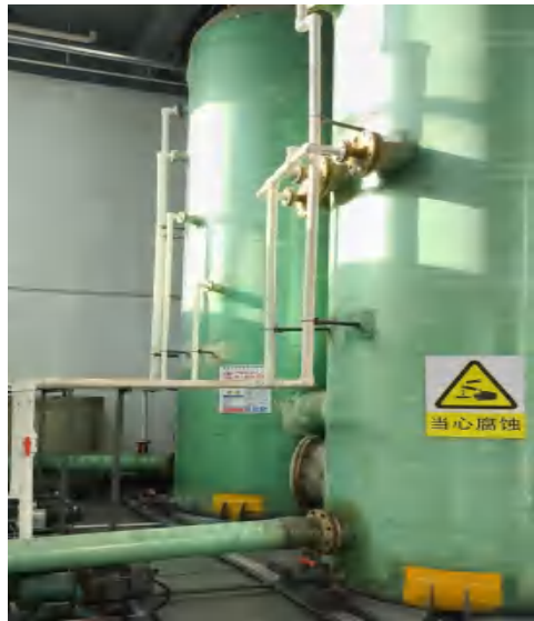
一级喷淋塔、二级喷淋塔
