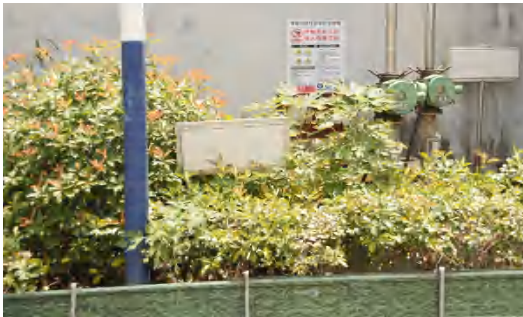
图 4.2-2 事故水池（地下）和雨污切换阀（右侧绿色）
