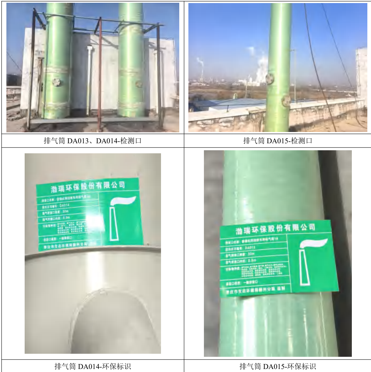
图 4.1-1 废气治理设施
