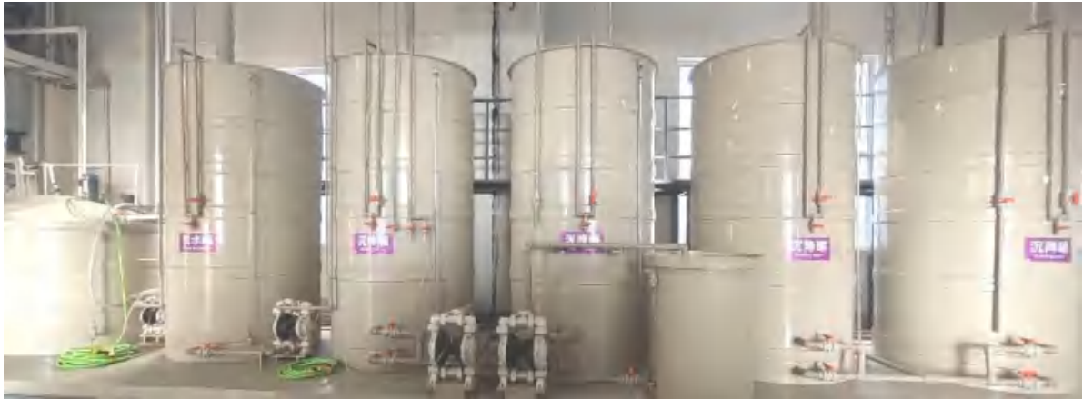
图 4.1-2 催化剂车间废水预处理设施
