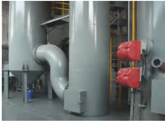
二次燃烧系统+水冷交换+烟气急冷设施
