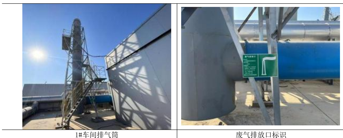
图 4.1-3 废气处置相关设施
