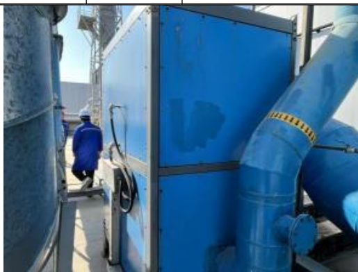
1#生产车间废气治理措施
